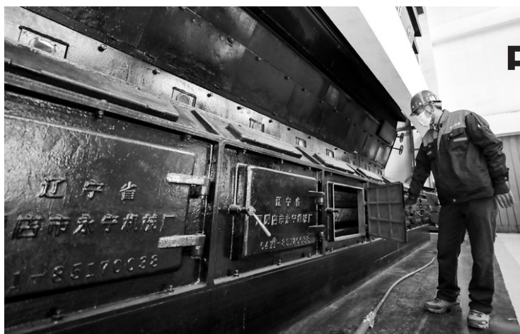
图为2021年11月2日,在河北省大厂回族自治县一供热公司,工作人员在查看供热设备运行情况。
