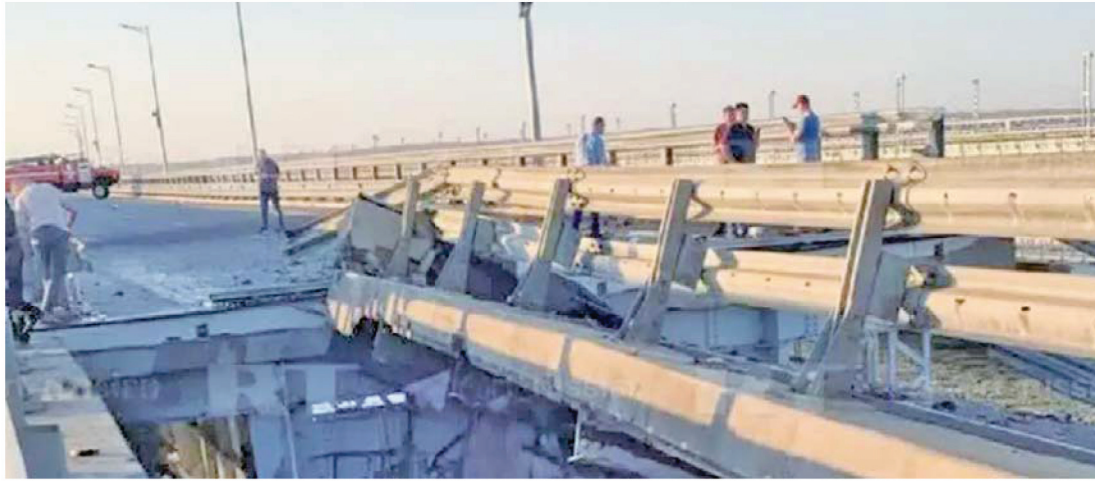
受损的克里米亚大桥 (视频截图)
